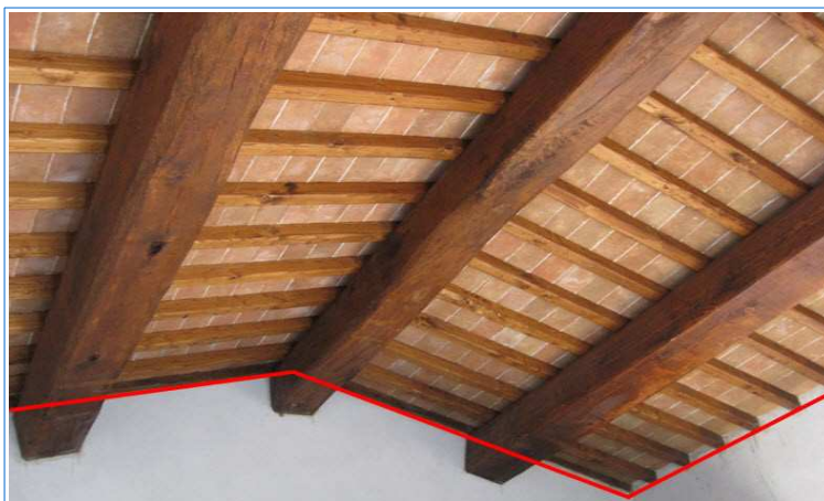
Illustrazione 6: intradosso di strutture composte con interasse dell'orditura secondaria non superiore a 80cm
